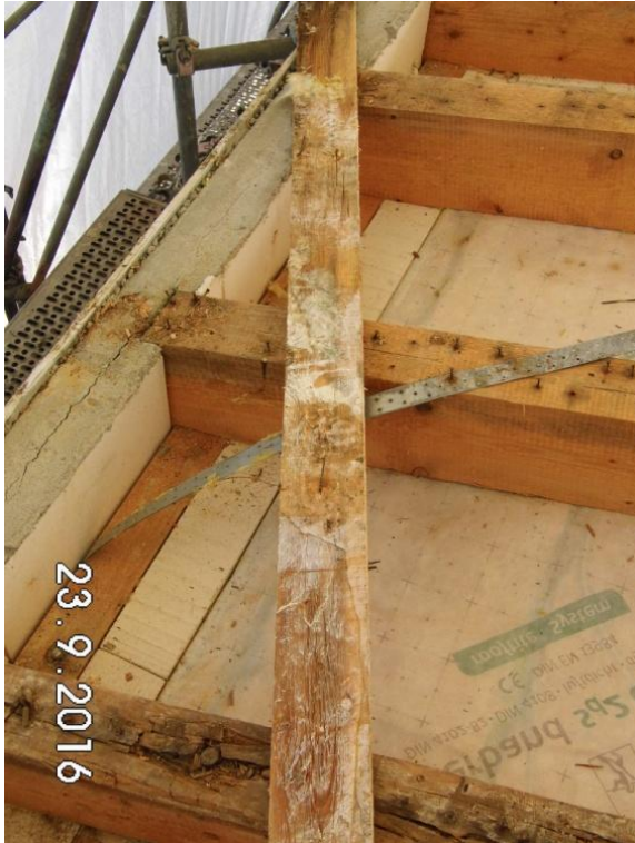
Geschädigte Sparren nach dem Entfernen der Bretter und der Dämmwolle, Dampfbremsfolie, die offensichtlich nicht dicht war
