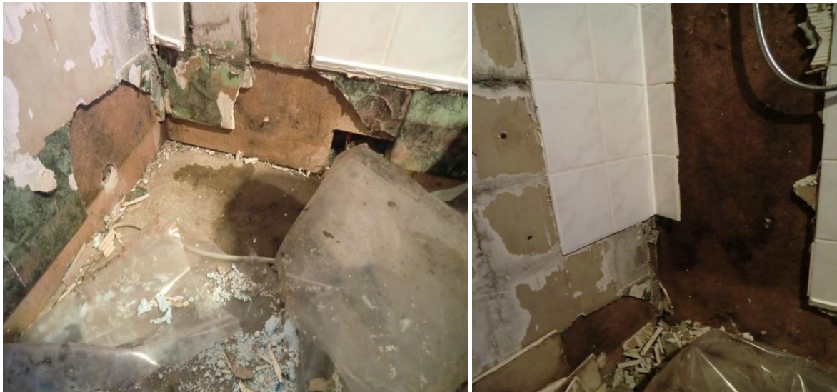
Undichtigkeiten im Fliesenbelag der Dusche führen zum Quellen der Holzkonstruktion
