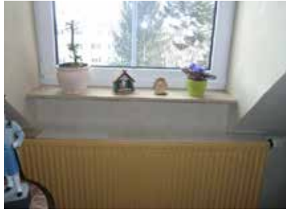
Abb. 3: Konvektionsheizkörper mit Plattenabdeckung
