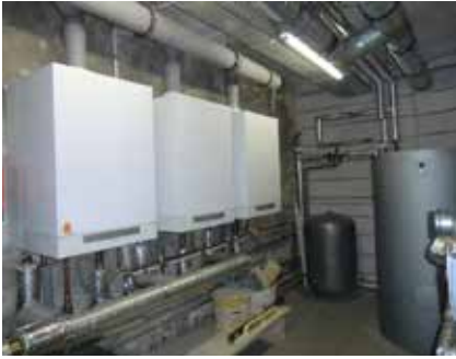
Abb. 8: Drei Thermen im Keller, die nach Bedarf und kaskadierend betrieben werden
