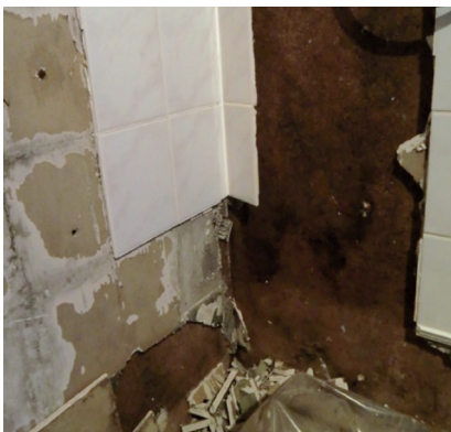
Abb. 3: Die Gipskartonplatten sind völlig mürbe, das Papier klebt an den abgefallenen Fliesen, die Spanplatten sind feucht und gequollen
