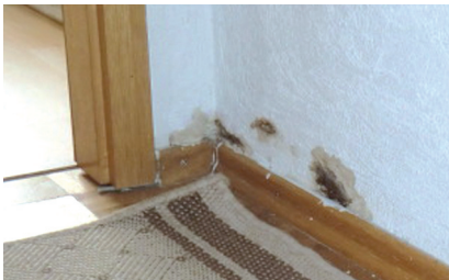
Abb. 1: Flecken an der Innenwand zum Bad
