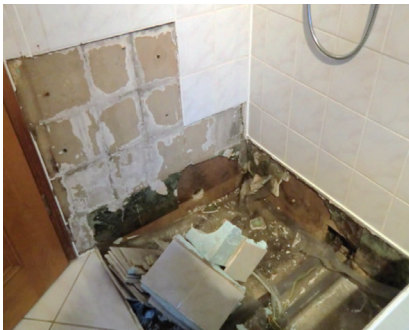
Abb. 2: Beim Ausbau der Dusche fielen Fliesen von der Wand. Die grünen Gipskartonplatten sind verschimmelt
