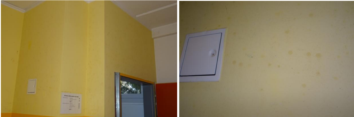
Foto 9 und 10 – zahlreiche und deutlich sichtbare Flecken an der Innenwand
