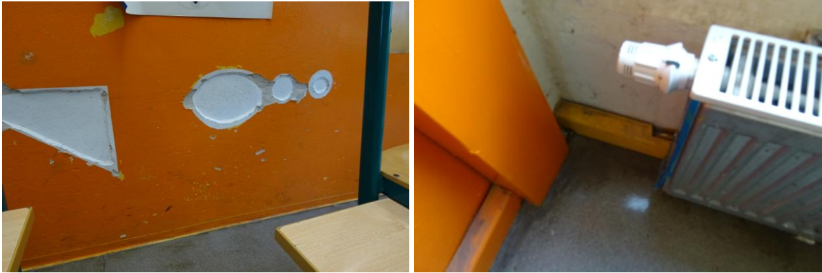
Foto 3 und 4 – Fehlstellen im Putz; starke Verunreinigungen an der Außenecke
