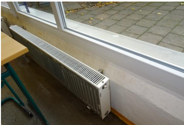
Foto 11 – Verunreinigungen unterhalb des Fensters an der Wand
