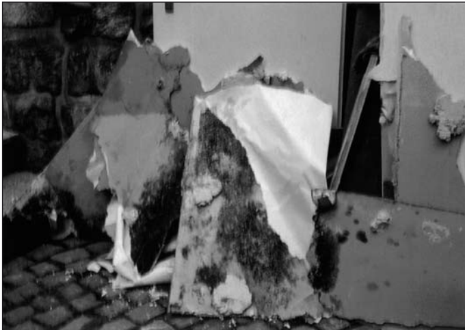
Abb. 2: Ausgebaute Gipskartonplatten mit einer massiven Schimmelpilzbildung auf der Rückseite
